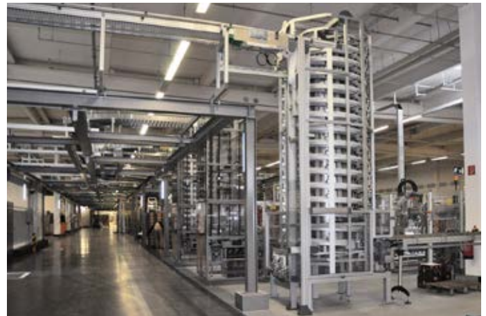
Für eine große Rösterei plante, entwickelte und installierte MiniTec eine individuelle Materialflusslösung.
